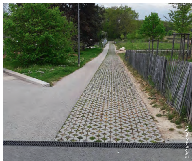
Der ebene Belag mit hohem Gehkomfort lässt sich mit begrünter Flächen kombinieren.
