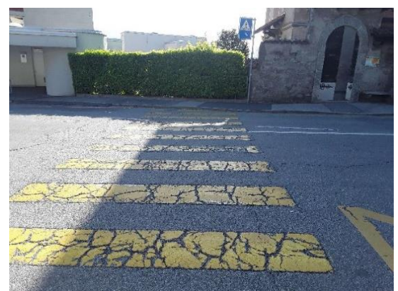
Abbildung 43: Schlechter Zustand der Markierung und fehlende Warteräume (Bellinzona)
